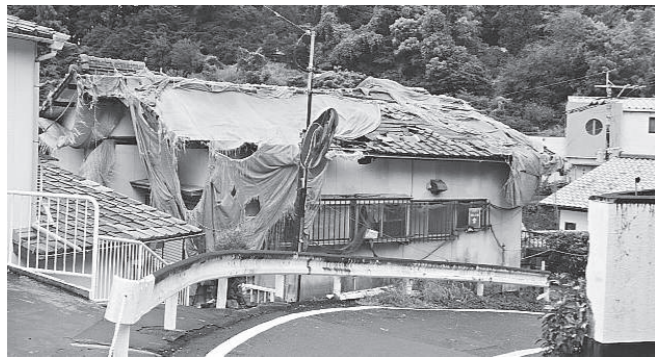
老朽危険空き家
