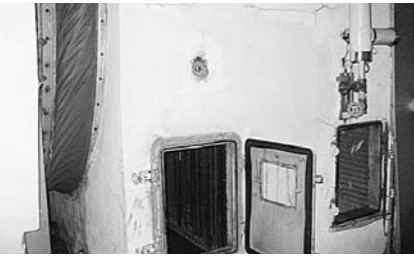
【空調設備】 昭和37年の開館当初からのもので、蒸気漏れ等の不具合が発生。内部腐食も進んでおり、利用者から音がうるさい・冷暖房の効きが悪いなどの苦情がある。
