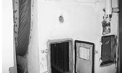
【空調設備】昭和37年の開館当初からのもので、蒸気漏れ等の不具合が発生。内部腐食も進んでおり、利用者から音がうるさい・冷暖房の効きが悪いなどの苦情がある。
