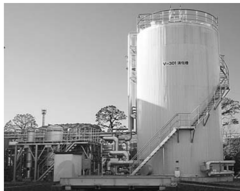
東部処理場で実証実験されている下水汚泥処理プラント
